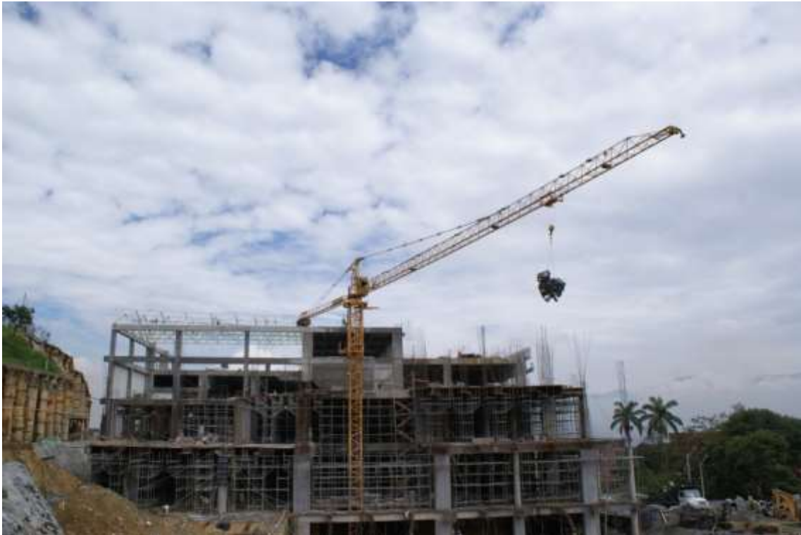
Figura 3 Torre grúa, equipo para transporte horizontal y vertical. Fotografía tomada en febrero de 2011.
