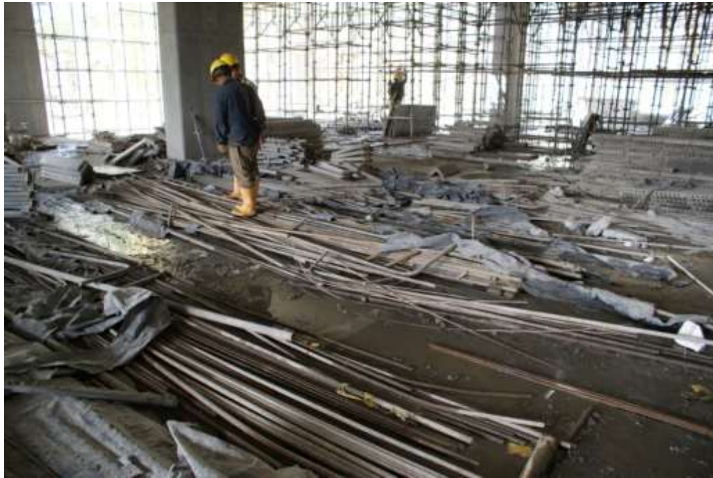
Figura 1 Carencia de sistema de almacenamiento en obra 1B. Fotografía tomada por David Restrepo Mora en febrero de 2011.
